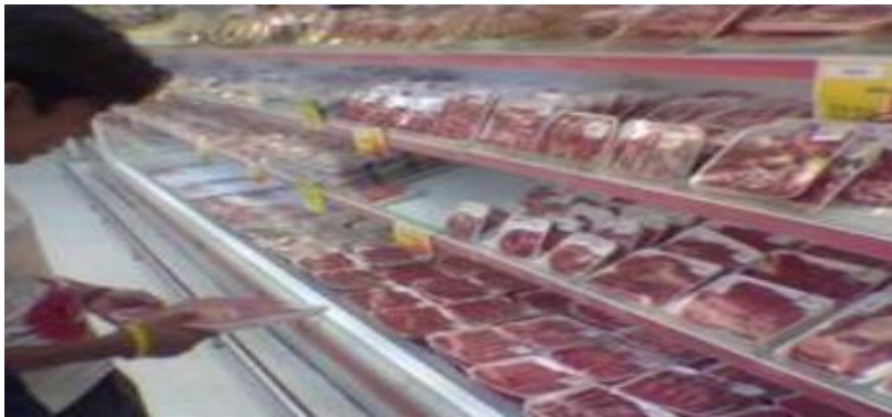
Figura 6 sistema de Refrigeración
